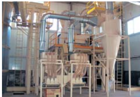
Impianto di pulitura e spietatura Cleaning and de-stoning plant
